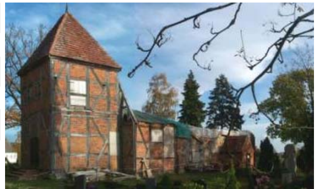
Ansicht nach Dacheinsturz und Sicherung
