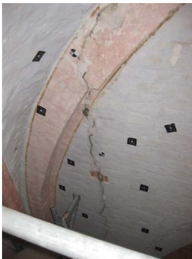
Riss durch Schildwand, Photogrammetriepunkte
